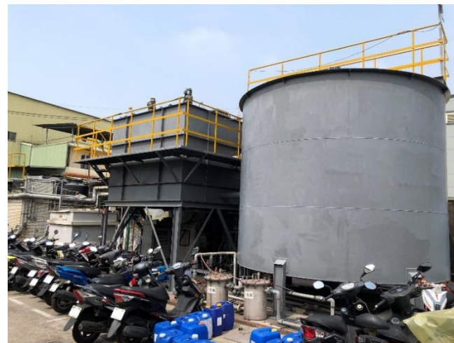
■ 廢水處理設施
